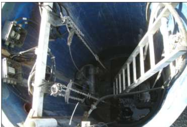
Figure 9 : Station de relevage des eaux usées du Jorax
